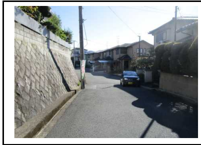
写真2 盛土末端付近の状況
