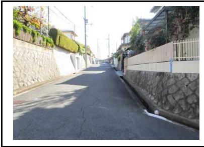
写真1 盛土末端付近の状況
