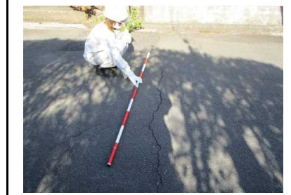
写真18 路面のクラック
