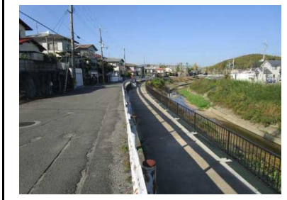
写真2 盛土末端付近の状況
