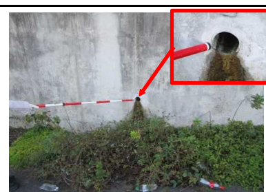
写真9 写真8擁壁水抜き穴から出水を確認
