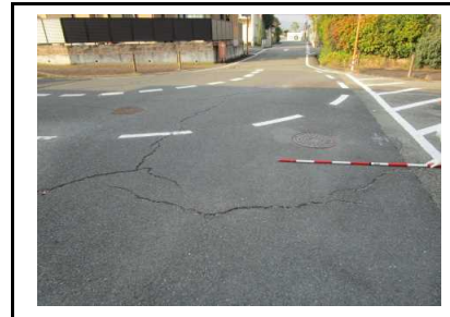
写真8 路面のクラック
