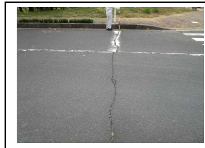
写真23 路面のクラック
