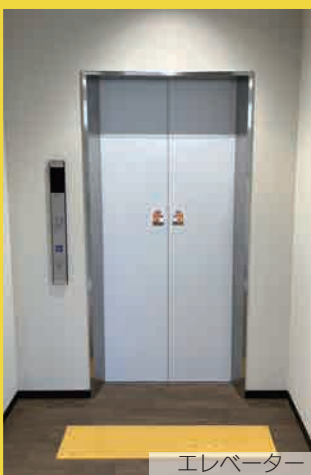
エレベーター
