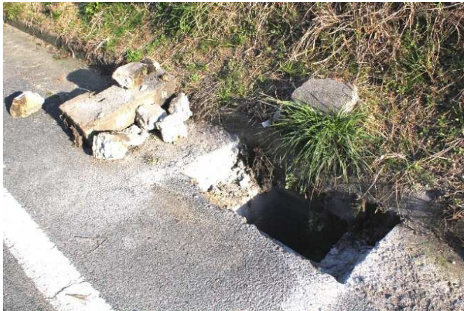
←穴の開いた排水溝
