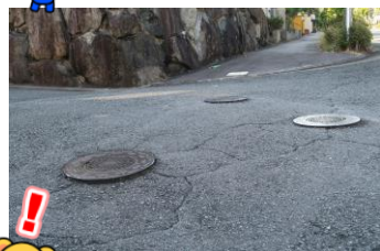
マンホール蓋の段差
